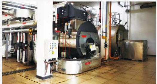
扬子江药业集团广州海瑞药业有限公司空预锅炉
