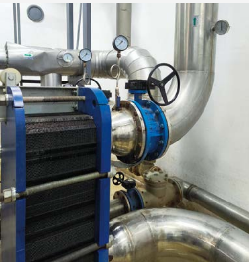
扬子江药业集团江苏龙凤堂中药有限公司余热回收装置
