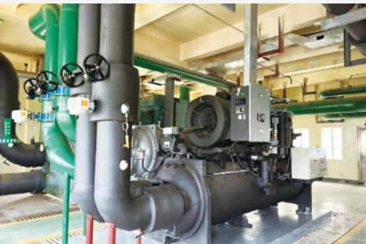
扬子江药业集团有限公司电制冷设备
