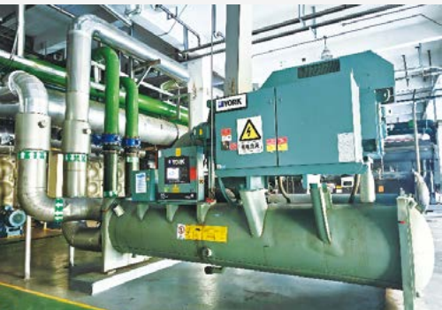
扬子江药业集团江苏紫龙药业有限公司电制冷设备
