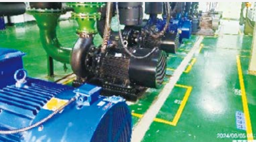
扬子江药业集团南京海陵药业有限公司循环水泵
